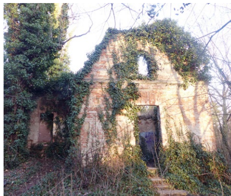
Hřbitovní kaple s márnicí je již přes pětatřicet let v troskách.
