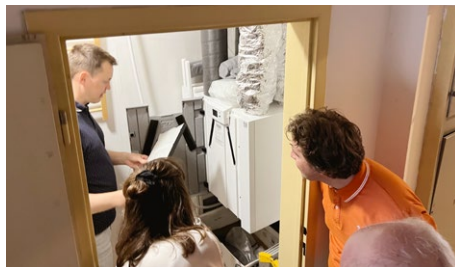
Rekuperační jednotka v technické místnosti.
