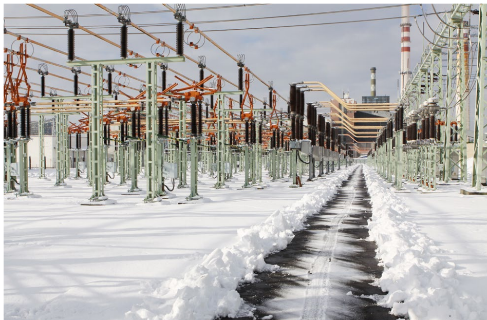
Rozvodna v Malešicích v zimě 2019. Foto: PRE
