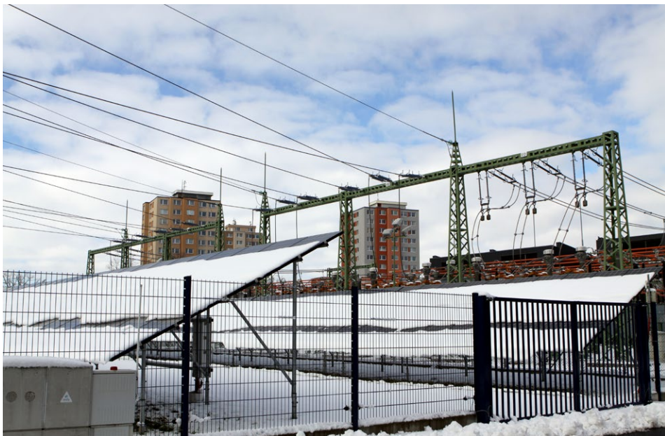
Solární panely zapadané sněhem na fotovoltaické elektrárně v Praze na Lhotce. Foto: PRE
